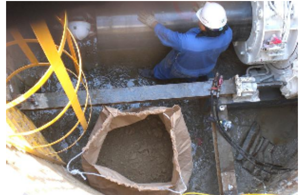
土砂排出状況
