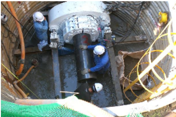
土砂排出状況
